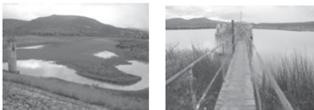
Figura 3. Azolvamiento de presas y deterioro de sus estructuras y mecanismos de operación que reducen su aprovechamiento.
